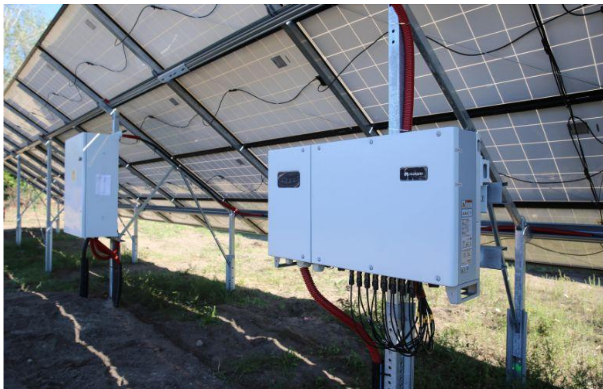
Figuur 1 Voorbeeld omvormer op een ander zonnepark
